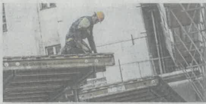
Die Baukosten für die Brücke sind sehr hoch, weil Zinsen steigen und Investitionen steigen.
